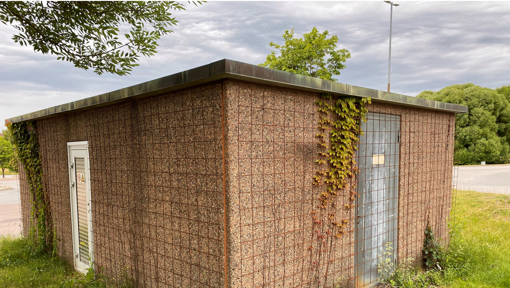
Elstation med armeringsjärn och växter
